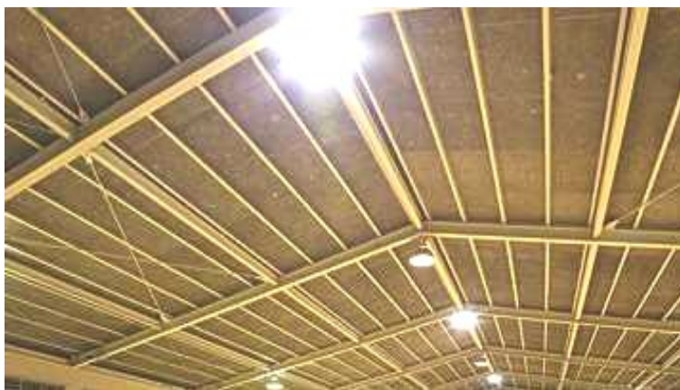
工場などの天井に設置
